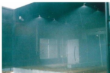
特殊水噴霧設備
