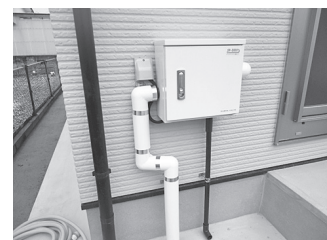
住宅に設置した電動弁ユニット
